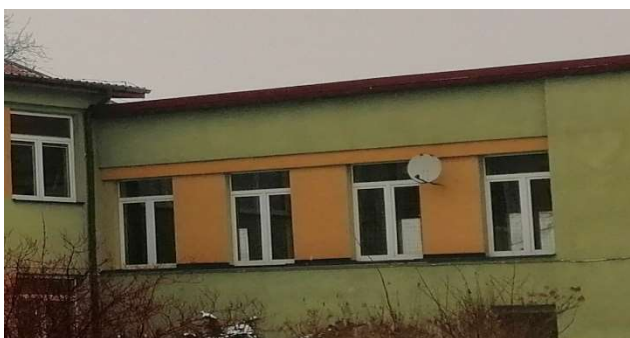
Rys. 20. Elewacja budynku obrazująca cofnięcie muru w okolicach okien
